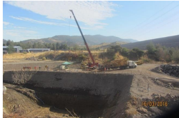
Montaje Grúa Torre. Se aprecia la excavación de la Casa de Máquinas.
