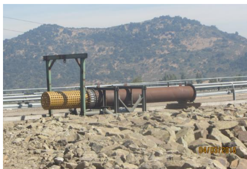
Spool N° 1 en el coronamiento del Muro Principal. Se aprecia su Filtro, Válvula Dúo Check y sistema neumático de apertura de las Tras-paletas de la Válvula.
