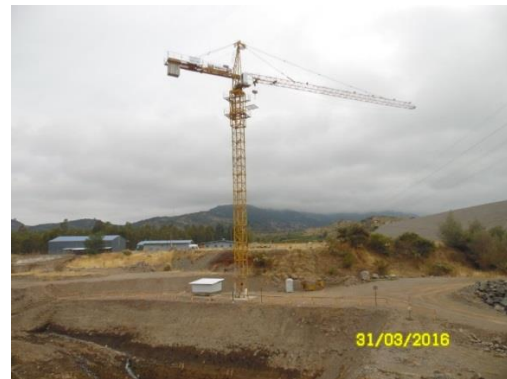
Trepado Grúa Torre de Vita Mac. Se aprecia el Generador de respaldo de 110 KVA con su caseta de protección.
