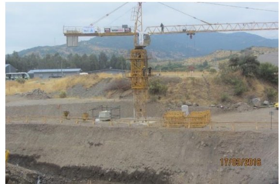
Trepado Grúa Torre de Vita Mac. Se aprecia el Generador de respaldo de 110 KVA.
